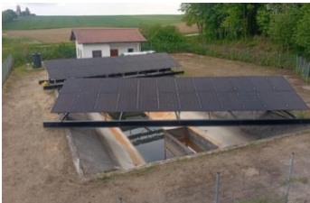
Photovoltaik Kläranlage Reichlkofen
